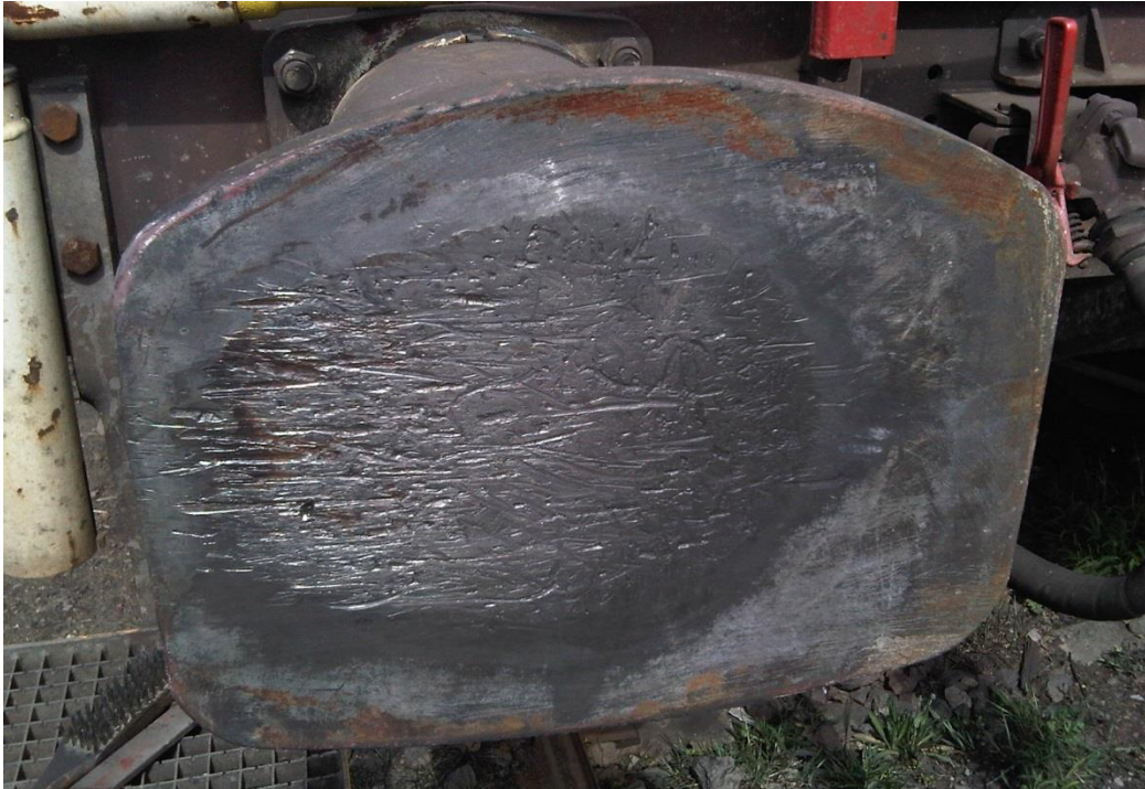
Rys. 17 Uszkodzona powierzchnia zewnętrzna tarczy zderzakowej
